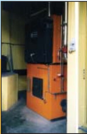
Vue de la chaudière.
