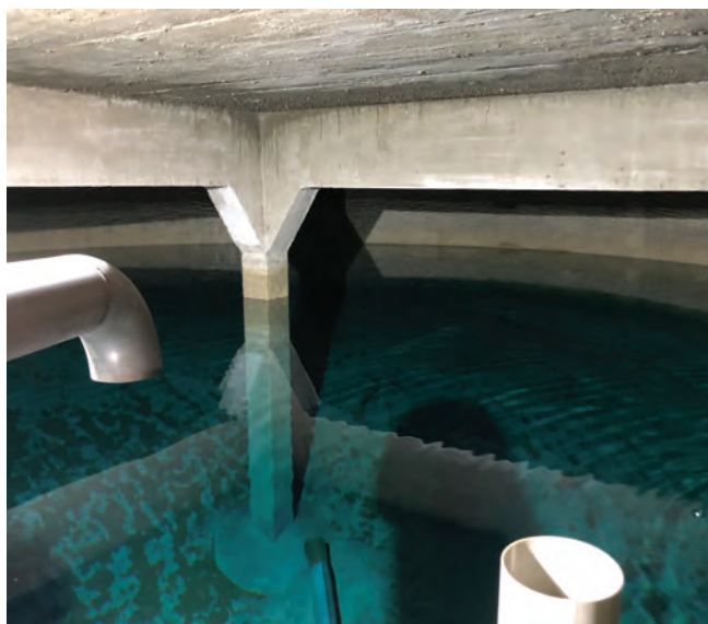
Le réservoir de Gibannaz est constitué de 2 bassins (200 m 3 et 2 000 m 3 ) et de 26 poteaux complètement enterrés sous la piste « Gentiane », il permet d'assurer la distribution d'eau pendant les périodes de forte consommation.
